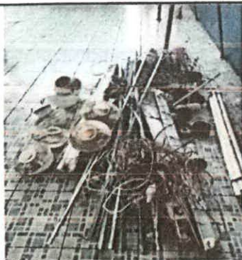
Foto 5. cambio de cableado antiguo interno en mal estado
